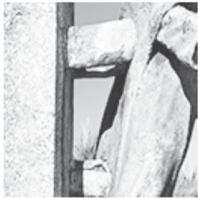
亀裂が入った支柱
